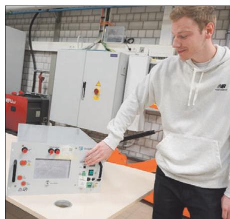
Der erste Elektrolyseur mit einer Leistung von 2,2kW wird derzeit installiert und für studentische und Forschungs-Arbeiten demnächst in Betrieb genommen. FOTO: HOCHSCHULE
