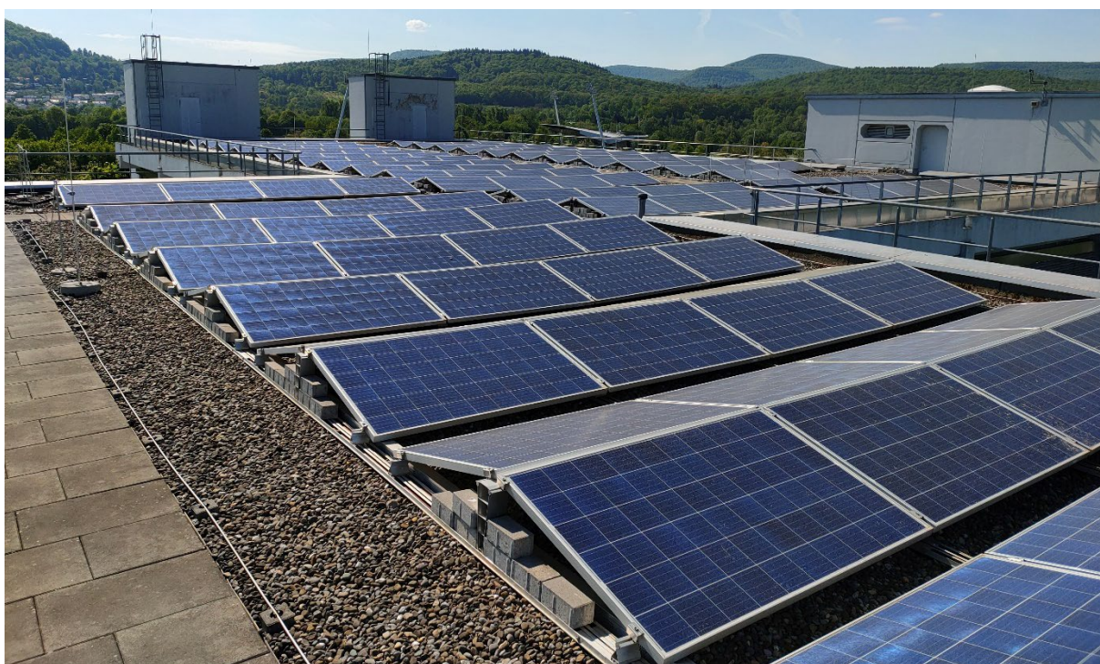
Abbildung 4: Photovoltaikdachanlage auf Gebäude 4 (© 2022 Hochschule Reutlingen)
