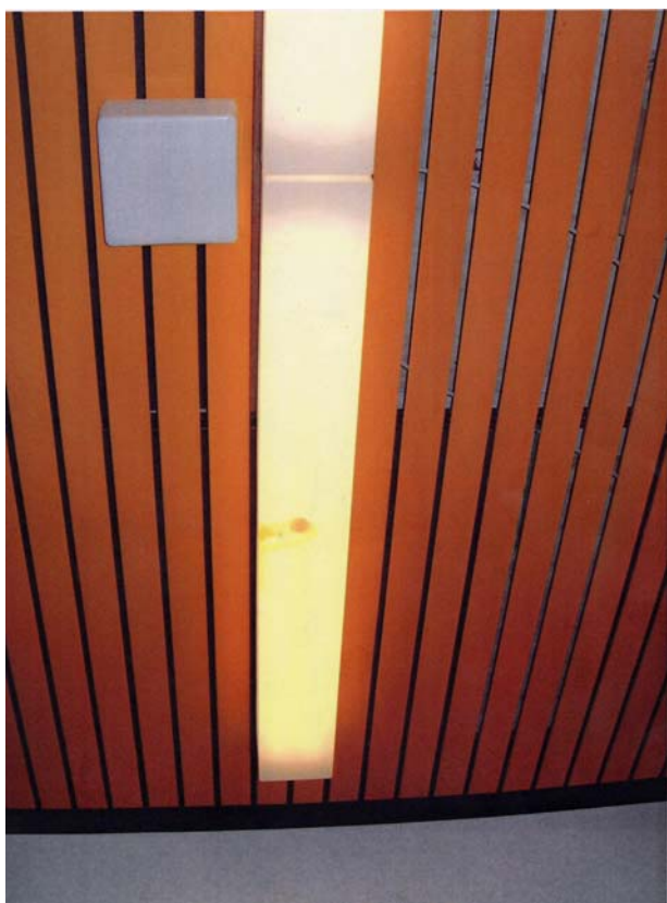
Abb. 7 PCB- Austritt aus Leuchtstofflampenkondensatoren
